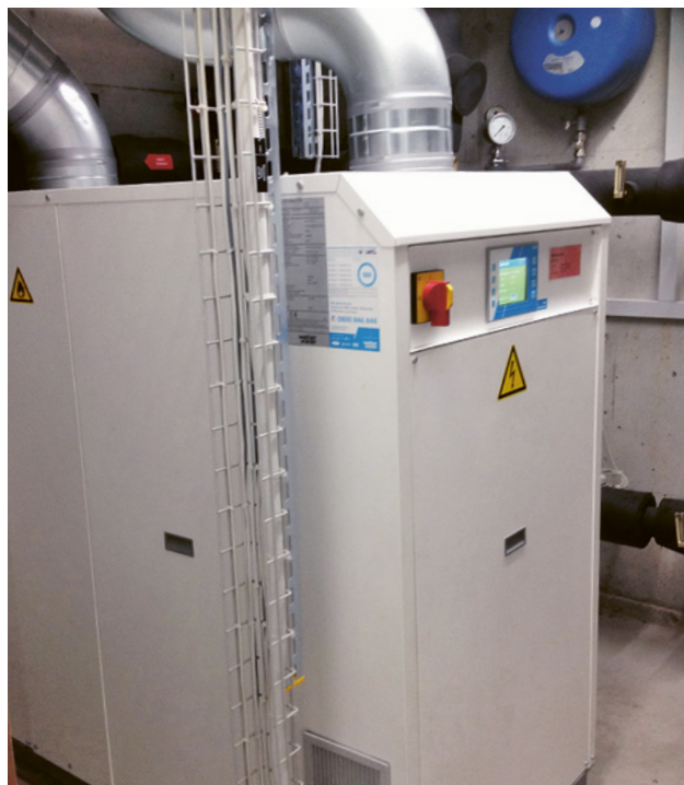
Sistema di refrigerazione in vano ventilato
