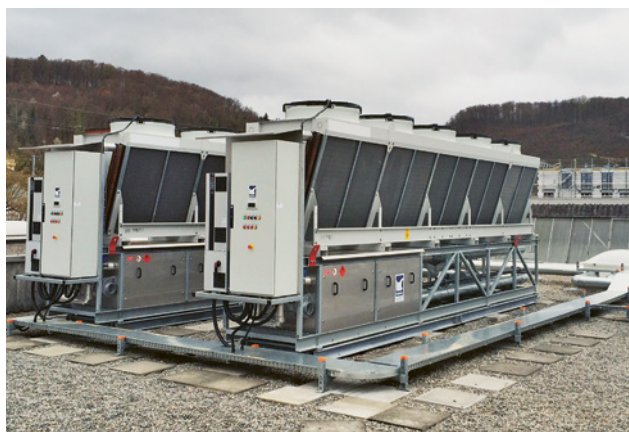
Sistema di refrigerazione all'aperto
